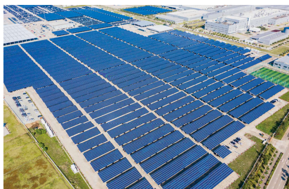
大型工商业光伏电站应用
