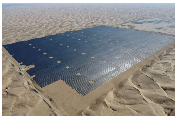
集中式地面光伏电站应用
